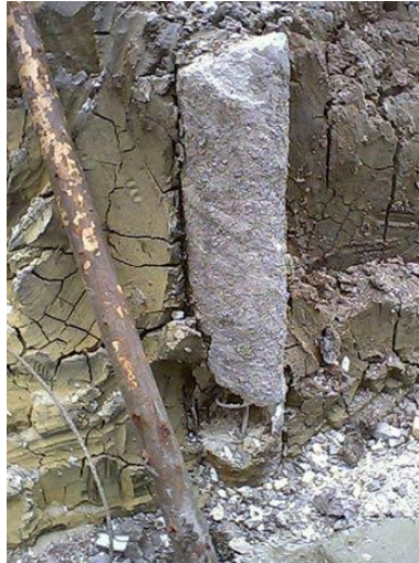
Figura 1 Pilote defectuoso fundido in-situ
