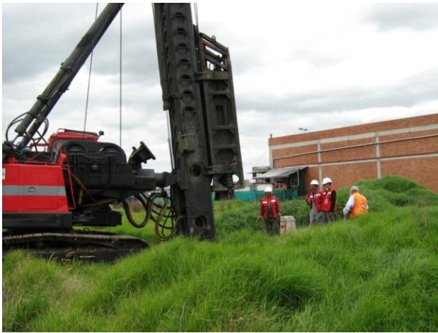
Foto No 2: Masa utilizada en las pruebas sobre los pilotes hincados. Masa de 6 ton de peso con una altura de caída de 0.80 m.
